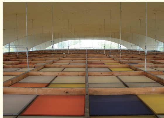
写真1: 中4階天井裏空間。ヴォールト状の屋根は鉄筋コンクリート・シェル構造。周囲から自然光がふんだんに取り入れられている。(筆者撮影)
