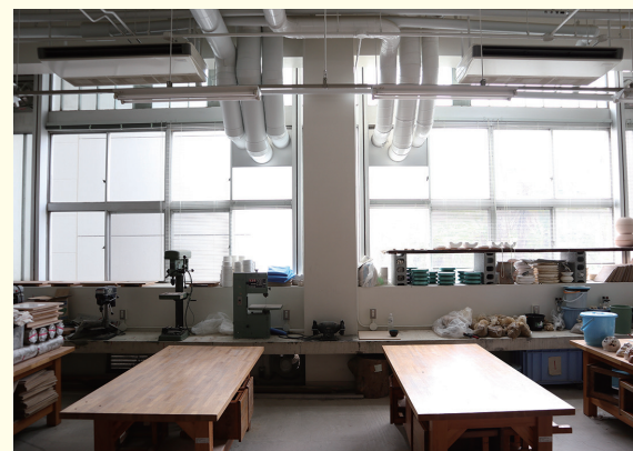
写真2:1階にある立体加工実習室の内観。天井面から窓に向かって排気ダクトが設置されている。よく見ると、床に近いところにも換気扇が付いている。(筆者撮影)
